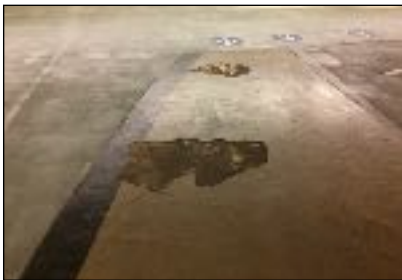
Schade op vloer
