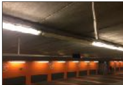
Defecte lampen, restanten
