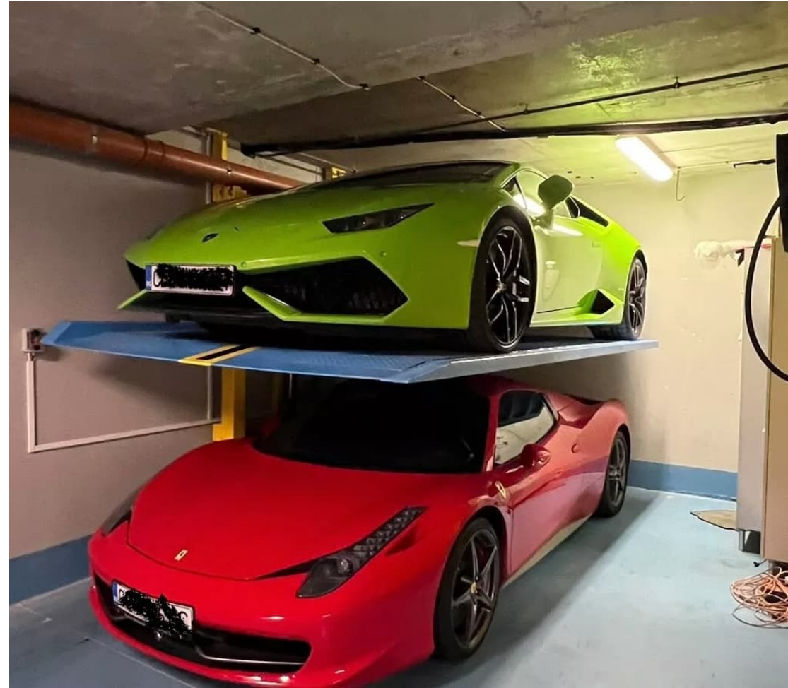
Voorbeeld autolift (bron: google)
